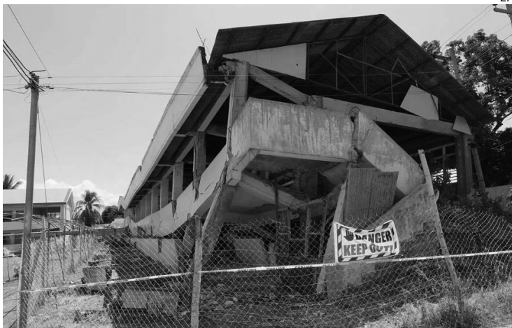
COLAPSO. Un edificio escolar inutilizable tras el terremoto en Davao.
