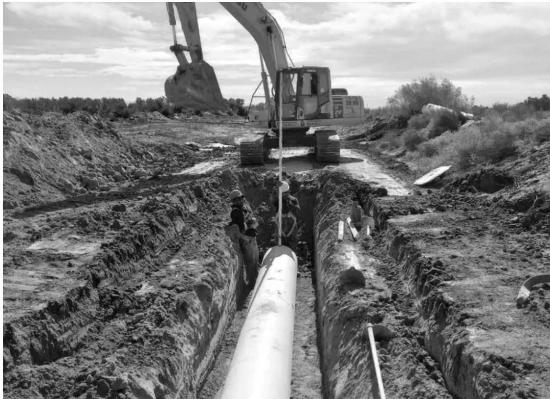
LOS CORRALITOS. El colapso de este colector es uno de los principales problemas sanitarios del Gran Mendoza.
