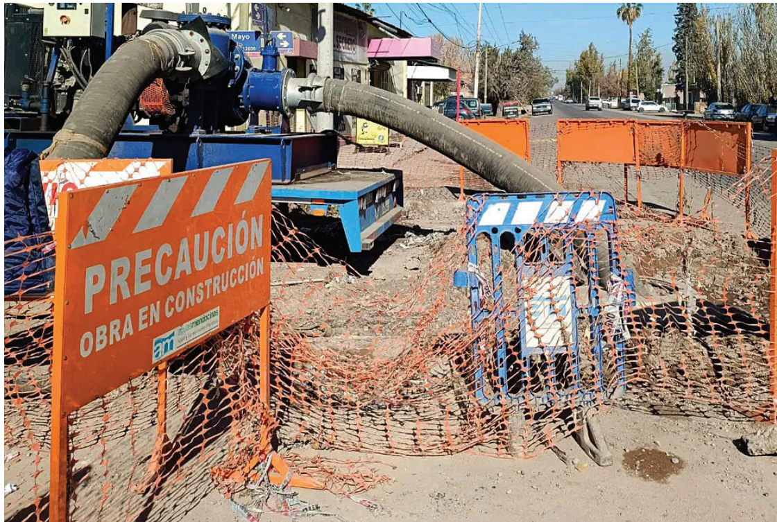
DERRAME. Por el vertido cloacal en Los Corralitos, la empresa proyecta obras por más de U$S 60 millones.
