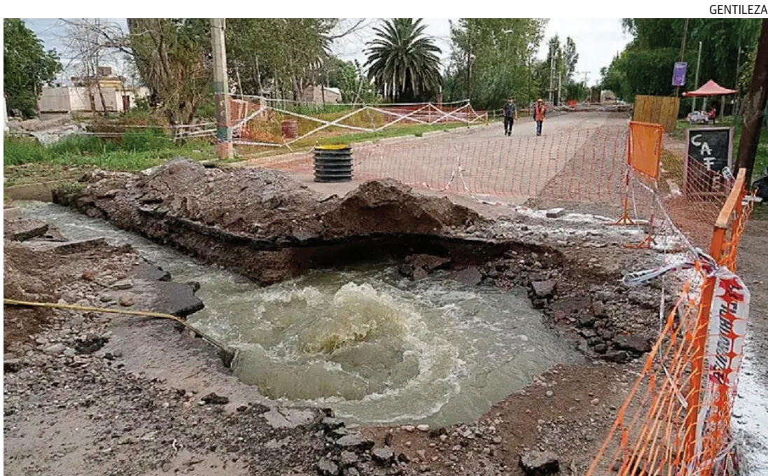
EMERGENCIA. Personal de Aysam trabaja para reparar un sector ubicado sobre calle Tirasso.
